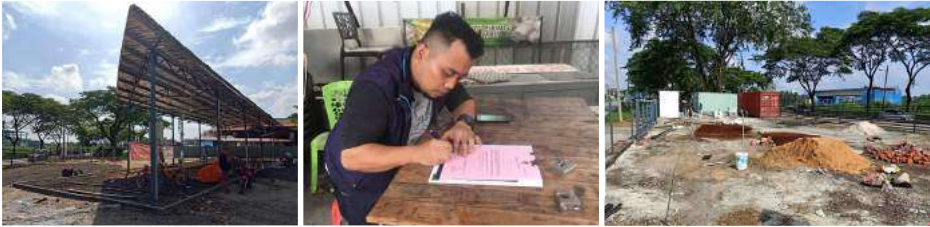
Membina bangunan sementara tanpa mendapat kebenaran Pihak Berkuasa Tempatan.
