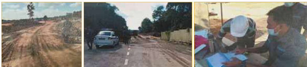
Pegawai Penguatkuasa menjalankan Operasi Jalan Kotor tersebut berpunca daripada aktiviti lori keluar masuk ke tapak projek pembinaan asrama pekerja di Jalan Senai jaya 2/2, Taman Senaijaya.
